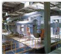
排煙処理装置
