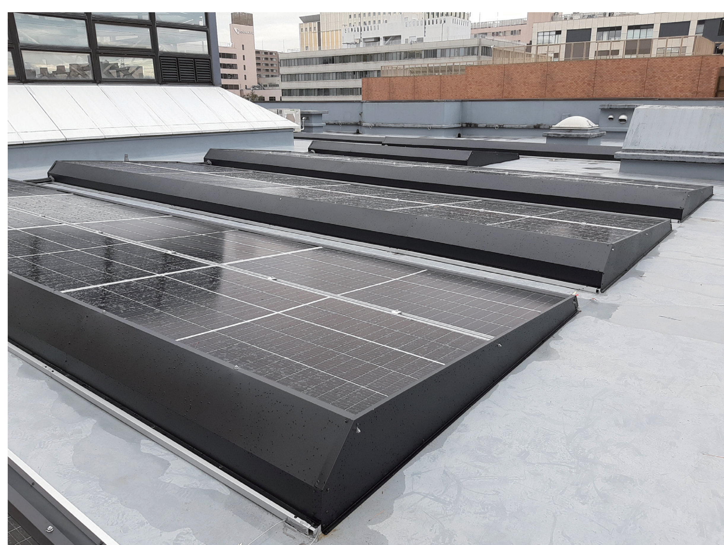
太陽光パネル（麻生市民館）
