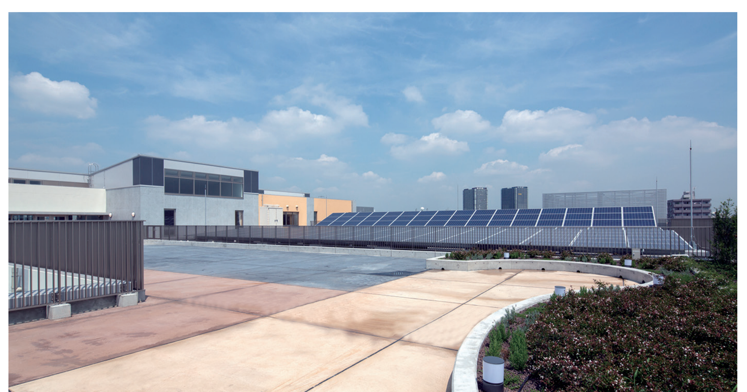
学校屋上の太陽光パネル
